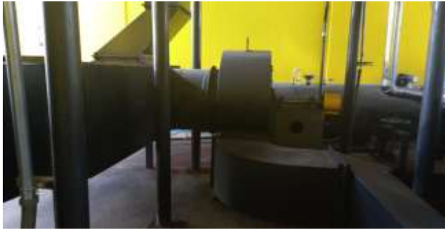
Foto. N° 04 Ventilador de Tiro
